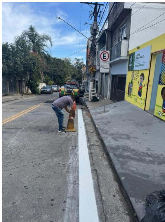
Sinalização e instalação da placa de parada do Transportador Escolar.
